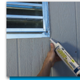
Rejillas de ventilación
